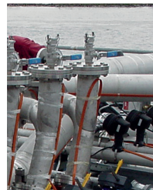
Cubierta de un buque cisterna con trazado calefactor en construcción
